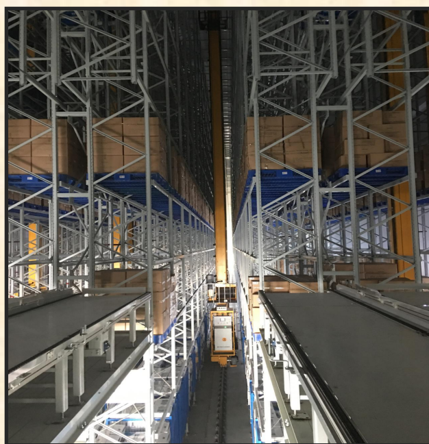
图2 山东安然纳米智能仓储物流配送系统
