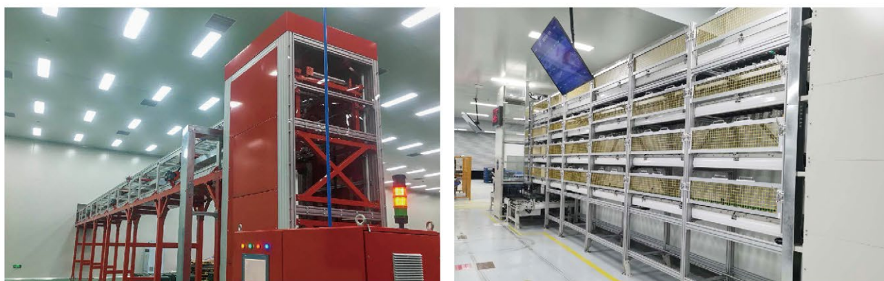
电芯高空输送线
