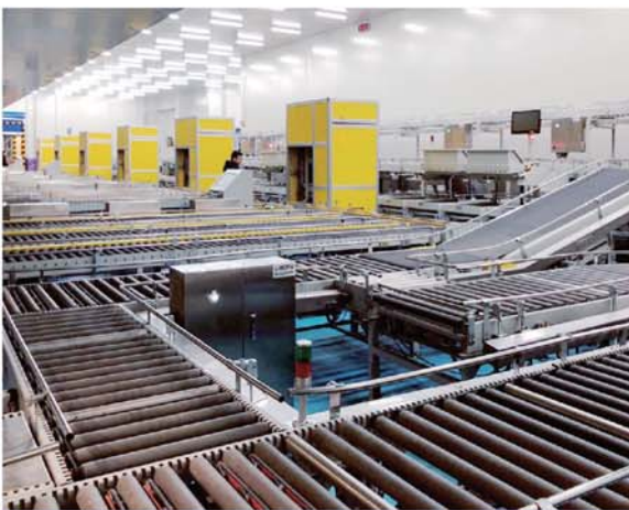
输送机系统 Conveyor System
